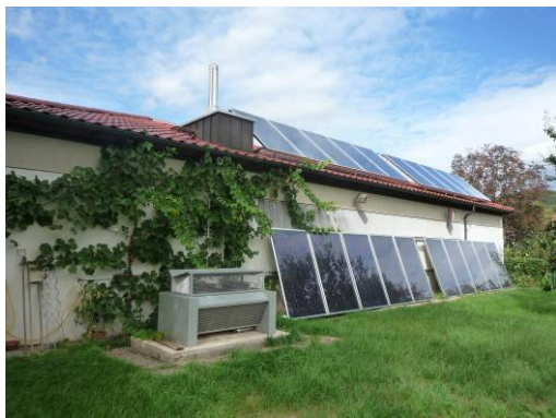
Kollektoranlagen mit Luftwärmepumpe
